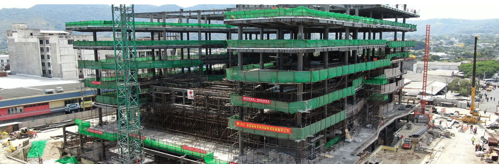
Foto: Diario El Salvador, 22 de febrero de 2023 “Termina la primera fase de construcción de la nueva biblioteca nacional de El Salvador” https://diarioelsalvador.com/termina-la-primer-fase-de-construccion-de-la-nueva-biblioteca-nacional/330450/
